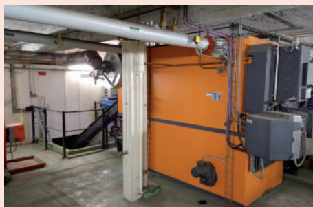
Chaufferie collective quartier Henri Bachelin
