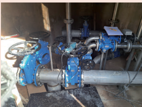
Etude diagnostique eau potable (télégestion au réservoir d'eau)
